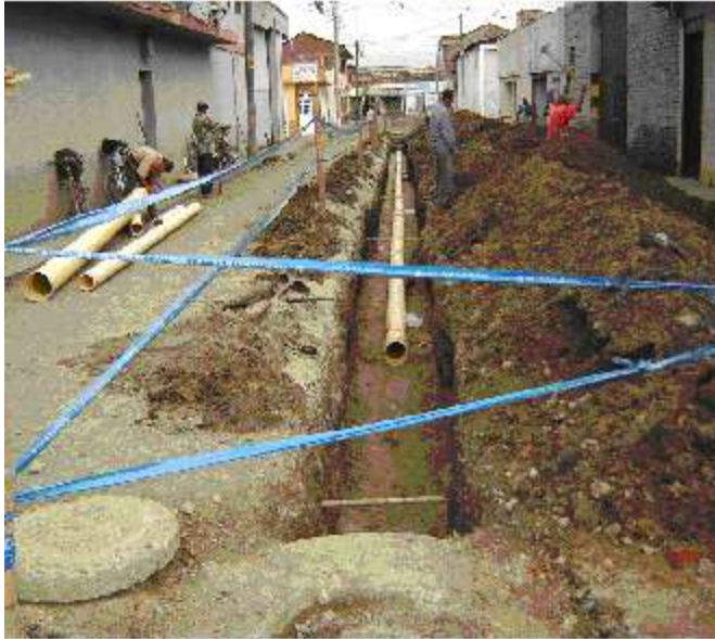
Red alcantarillado y acometidas domiciliarias Alfonso López
