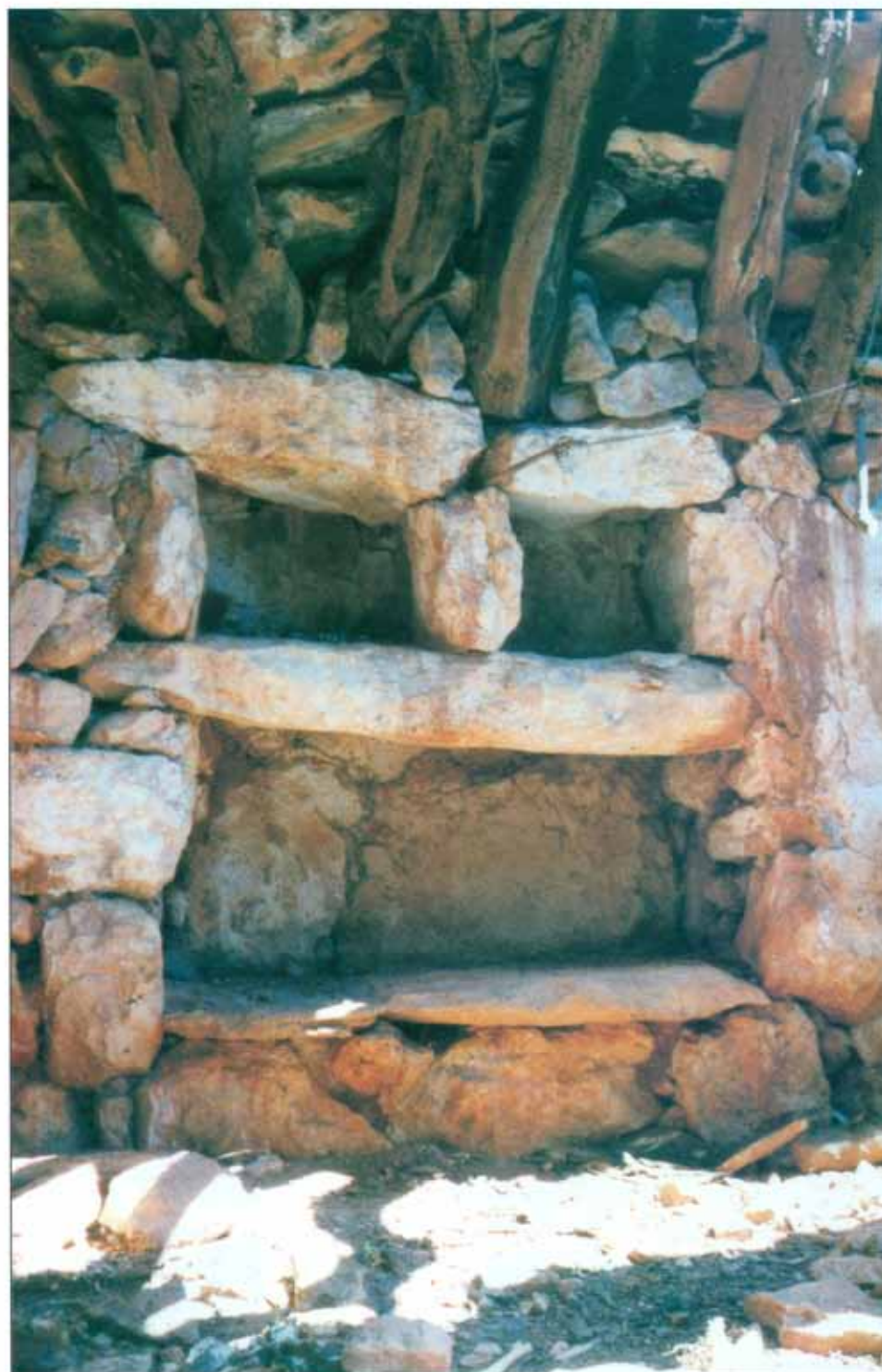
Rebosts superposats a l'interior d'una barraca de roter, el superior amb una separació.
