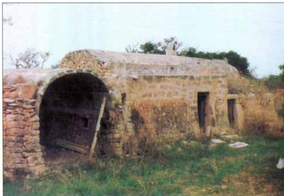
Barraca de roter i de carro en què les cobertes de lloses s'han substituït per peces de marès.
