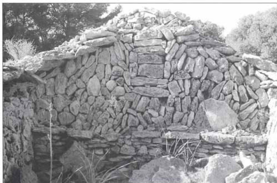
Interior d'una barraca de roter amb la coberta esbucada. Hi podem observar la posició i forma de la menjadora i el reforç de pedres de pla adobades on descansava el cap de la jàssera principal.
