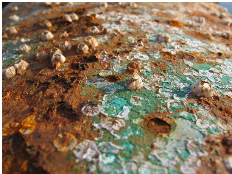
Oxidación del metal.
